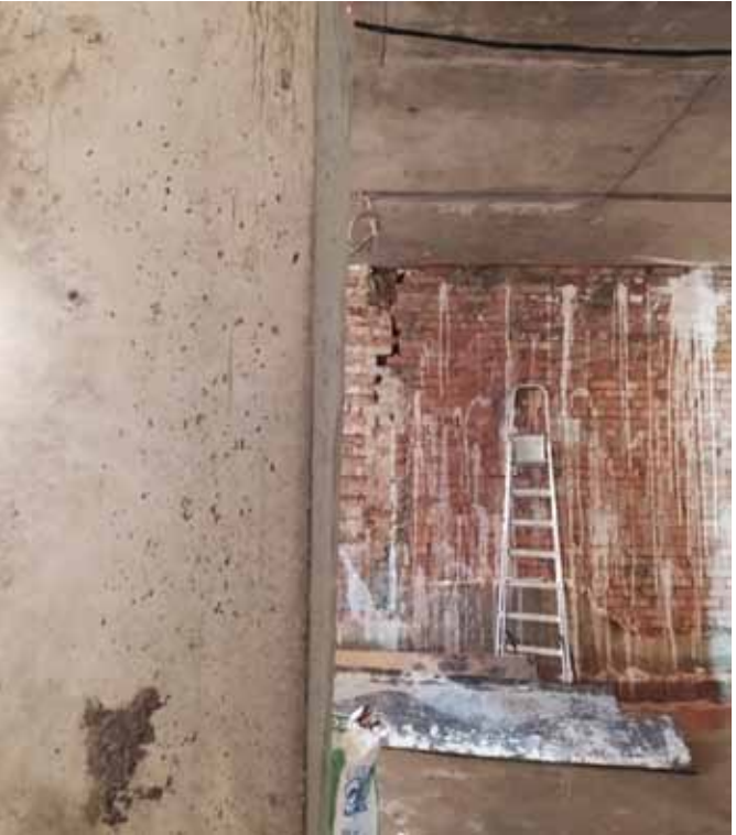
Фото 2. Отклонение поверхности монолитных железобетонных конструкций от вертикали Photo 2. Deviation of the surface of monolithic reinforced concrete structures from the vertical
