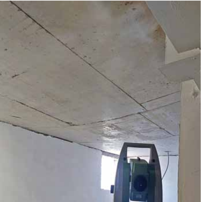
Фото 4. Отклонение горизонтальных поверхностей, в данном случае – провисание плиты перекрытия Photo 4. Deviation of horizontal surfaces, in this case – sagging of the floor slab
