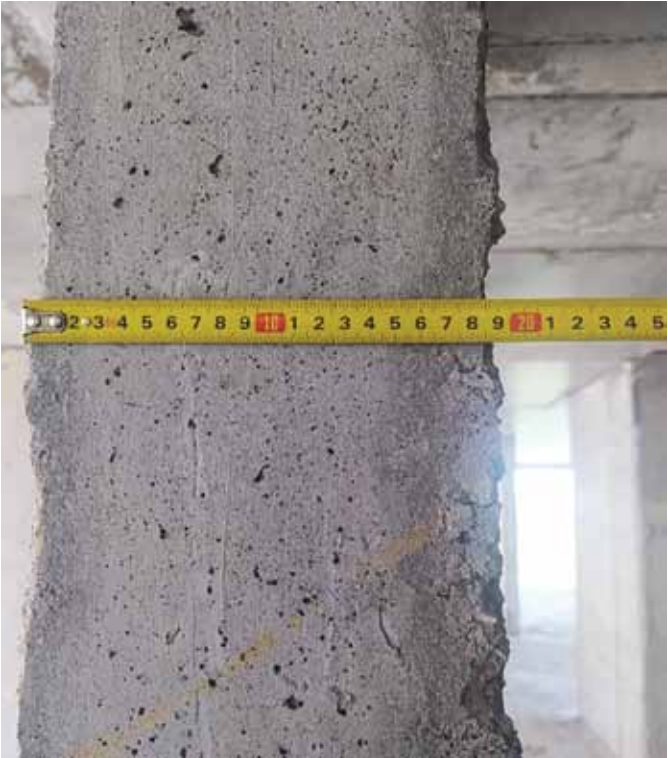
Фото 1. Отклонения размеров поперечных сечений, неровности на поверхности бетона Photo 1. Deviations in the size of cross-sections, irregularities on the concrete surface
