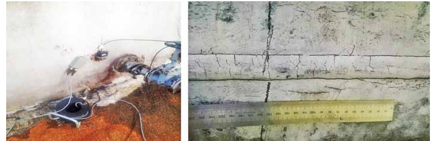
Рис. 2. а) Дефект уторного шва между днищем и стенкой резервуара; б) Наиболее опасный дефект КРН, на котором зафиксирована сеть продольных трещин в зонах сплавления сварного шва
