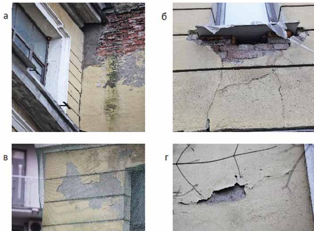
Рис. 1. Фрагменты разрушений кирпичной кладки, поверхности штукатурного слоя фасада в результате нарушений технологии оштукатуривания в процессе ремонтно-восстановительных работ: а) разрушения кирпичной кладки; б) разрушение кирпичной кладки, образование сетки трещин; в) утраты красочных слоев; г) отслоения штукатурного слоя от основы
