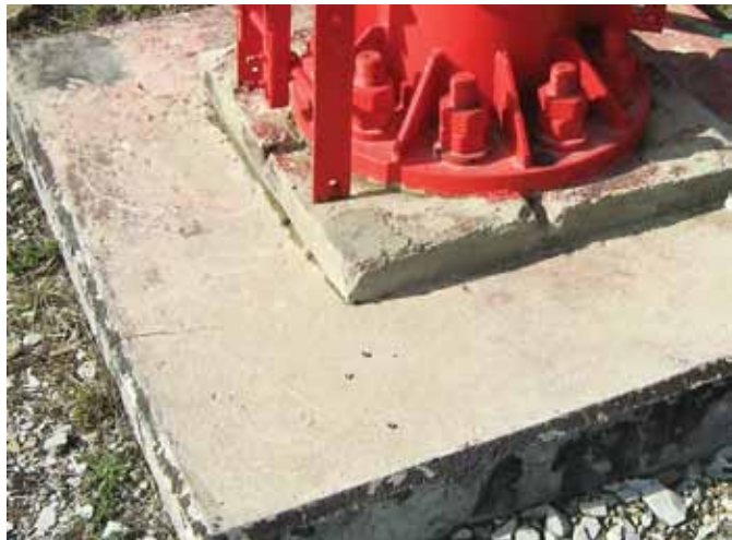
Рис. 4. Утрата защитного покрытия и усадочные трещины бетона фундамента пояса А Fig. 4. Loss of concrete cover and shrinkage cracks in concrete foundation of the girth A
