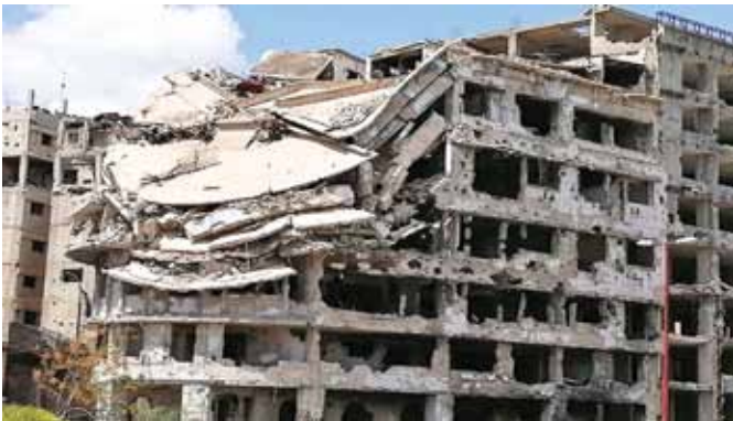
Рис. 6. Здание 3-й группы повреждений Fig. 6. Building of the third group of damage
