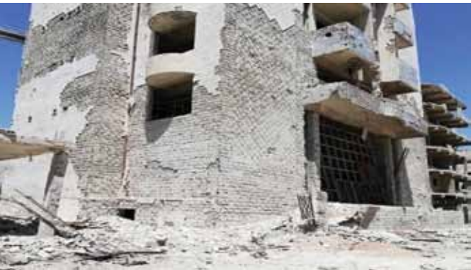
Рис. 5. Здание 1-й группы повреждения Fig. 5. Building of the first group of damage
