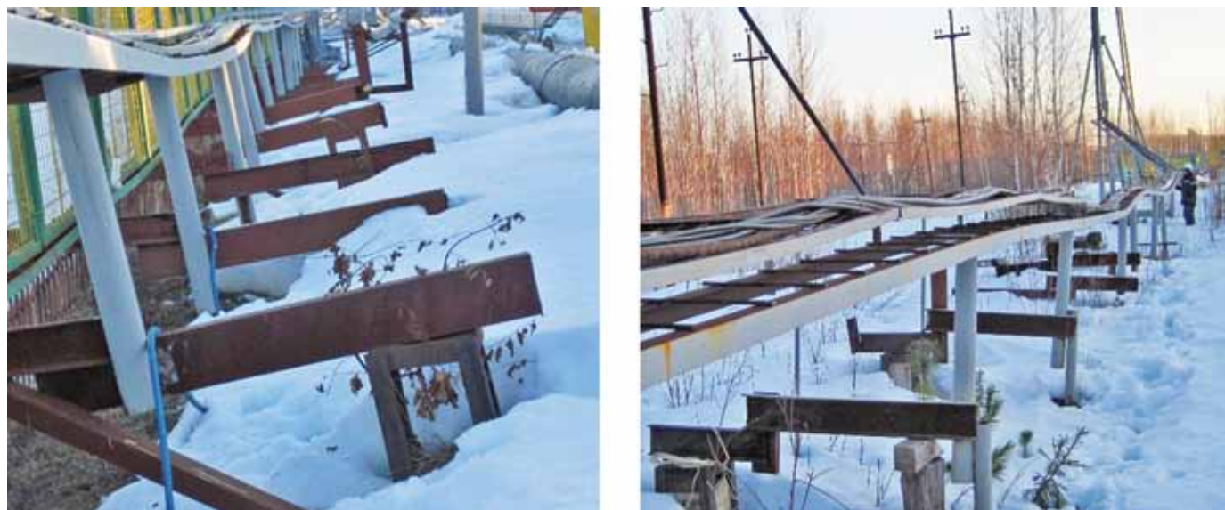
Рис. 10. Низкое качество СМР в совокупности с фактом строительства без проекта, из сортамента и материала «по месту» Fig. 10. Low quality of construction and installation work combined with construction works performed without a design and with the use of gauge and materials "on-site"
