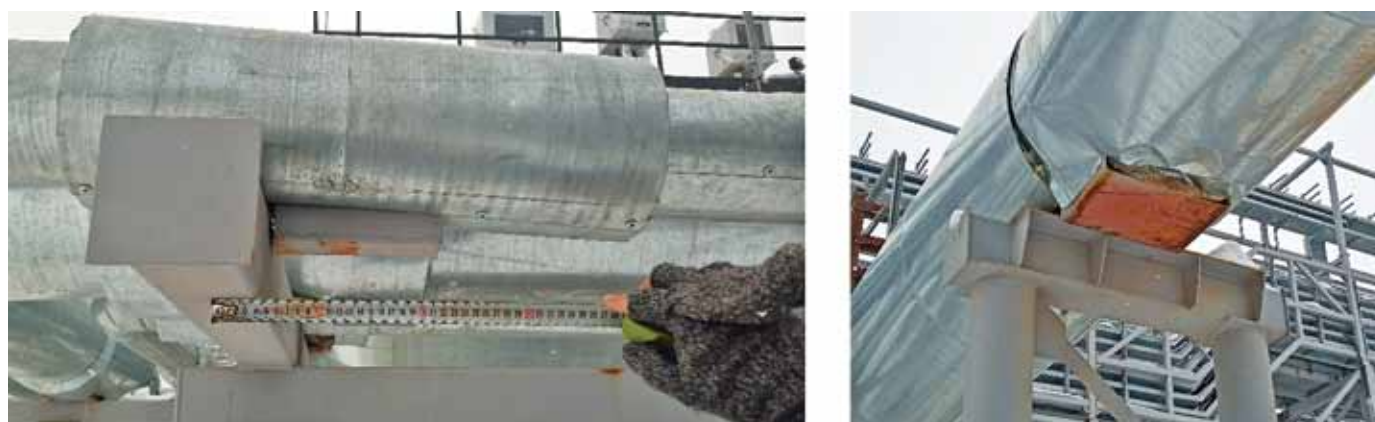
Рис. 12. Смещение с проектного положения подвижных опор на траверсах Fig. 12. Offset of traverses' movable supports from the final position
