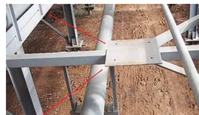
Рис. 9. Примеры дефектов в виде несмонтированных элементов, в том числе несмонтированного элемента решётки несущей фермы
