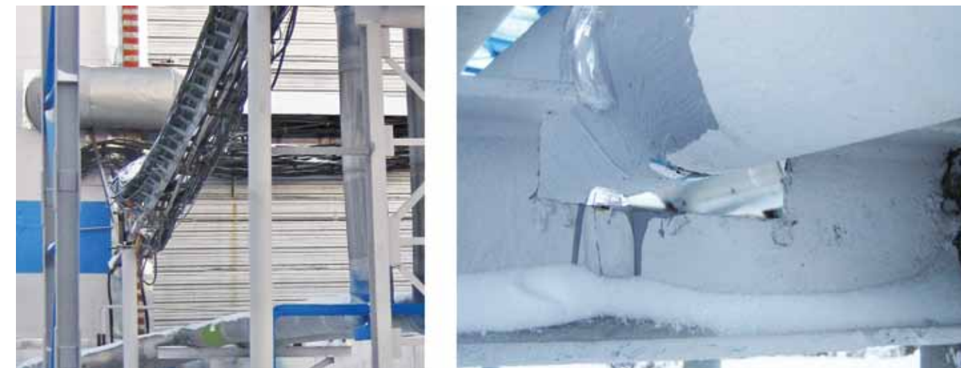
Рис. 13. Потеря общей устойчивости пролётного строения кабельной эстакады вследствие перегруза и ослабление сечения траверсы в результате прокладки трубопровода (нарушения условий эксплуатации)
