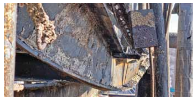
Рис. 6. Последствия воздействия высоких температур (пожара). Многочисленные деформации и потери устойчивости элементов эстакады
