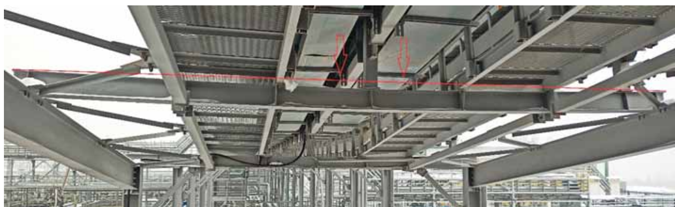
Рис. 11. Сверхнормативный прогиб и недостаточная несущая способность траверсы, выявленные сразу после ввода объекта в эксплуатацию
