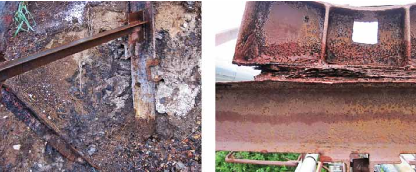
Рис. 2. Язвенная коррозия элементов, эксплуатируемых в грунте или на границе сред, и щелевая коррозия в узле сопряжения траверсы с опорой под трубопровод Fig. 2. Pit corrosion of elements operating in soil or environmental boundaries and crevice corrosion in a conjugation joint of a traverse and a support for pipeline
