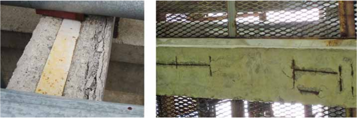
Рис. 3. Трещины и нарушения защитного слоя бетона, образовавшиеся в результате расширения продуктов коррозии арматуры Fig. 3. Cracks and failures of the protective layer of concrete formed as a result of expansion of corrosion products of reinforcement
