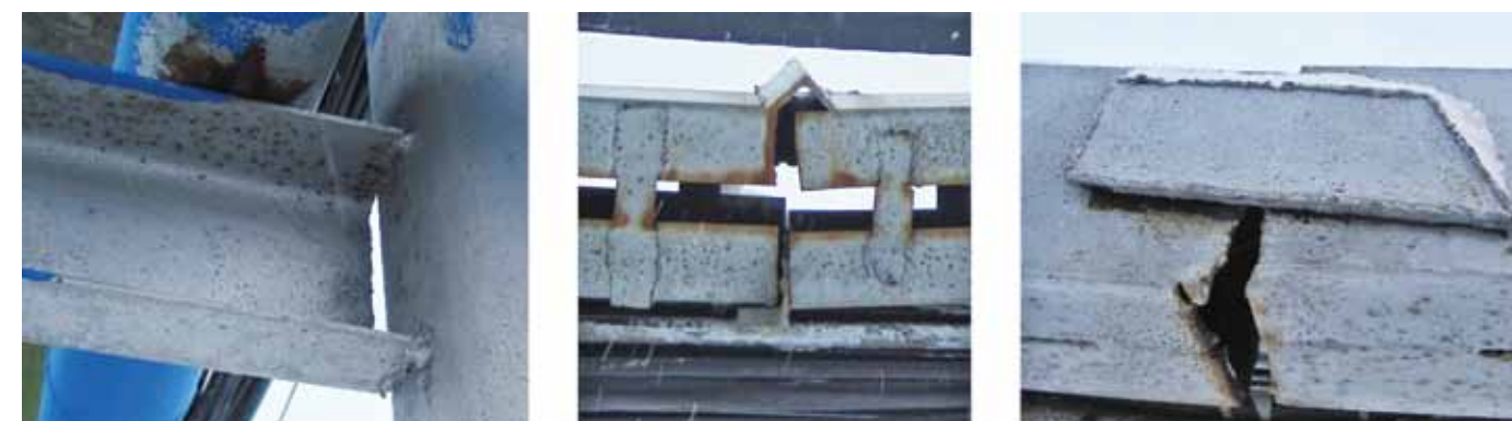
Рис. 8. Многочисленные дефекты сварных соединений
