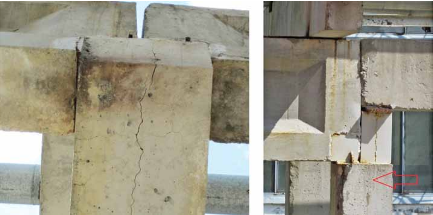
Рис. 4. Трещины деформационного (температурного) характера в месте опирания пролётных строений на колонну железобетонной эстакады Fig. 4. Deformational (temperature) cracks formed at the place where superstructures lean on a column of a reinforced concrete pier
