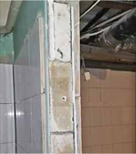
Рис. 2. Дефекты устройства перегородок из ГКЛ Fig. 2. Defects in the device of partitions from drywall sheets
