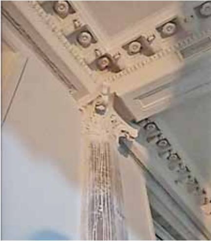
Рис. 4. Дефекты при малярных работах Fig. 4. Painting defects
