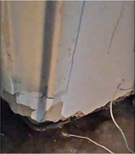
Рис. 3. Дефекты геометрии стен Fig. 3. Defects in wall geometry
