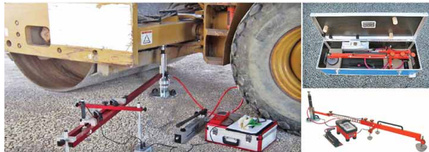
Рис. 3. Статическая штамповая установка (источник: https://ic-globalem.pro/ ) Fig. 3. Static plate testing unit (source: https://ic-globalem.pro/ )
