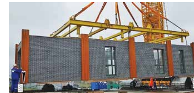
Рис. 6. Максимальный перекося крупногабаритного железобетонного модуля в подвешенном состоянии Fig. 6. Maximum misalignment of a large-sized reinforced concrete module in a suspended state
