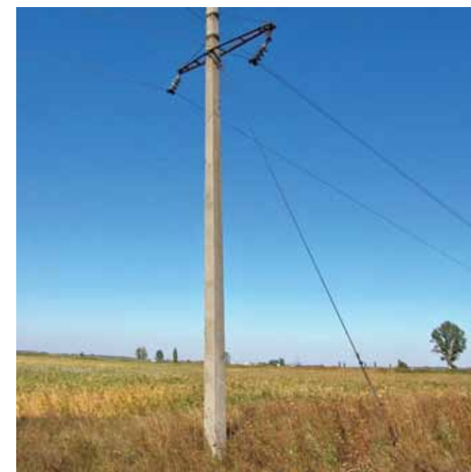
Рис. 1. Оттяжки на стойках ЛЭП мощностью до 10 кВт Fig. 1. Guys on power transmission poles with power up to 10 kW
