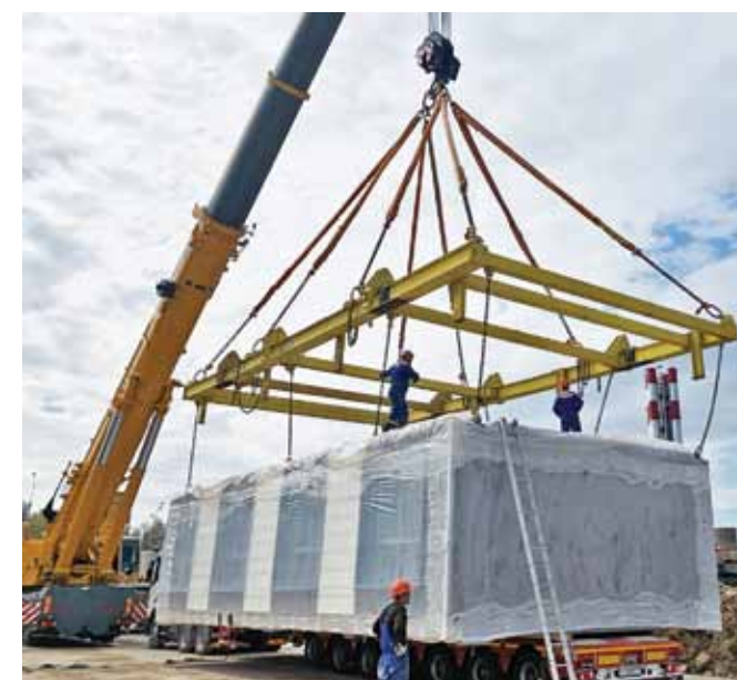
Рис. 3. Крупногабаритный объёмный блок, полностью готовый к монтажу Fig. 3. The large-sized volumetric block is completely ready for installation
